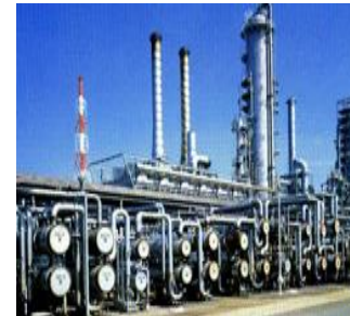
石油プラント
